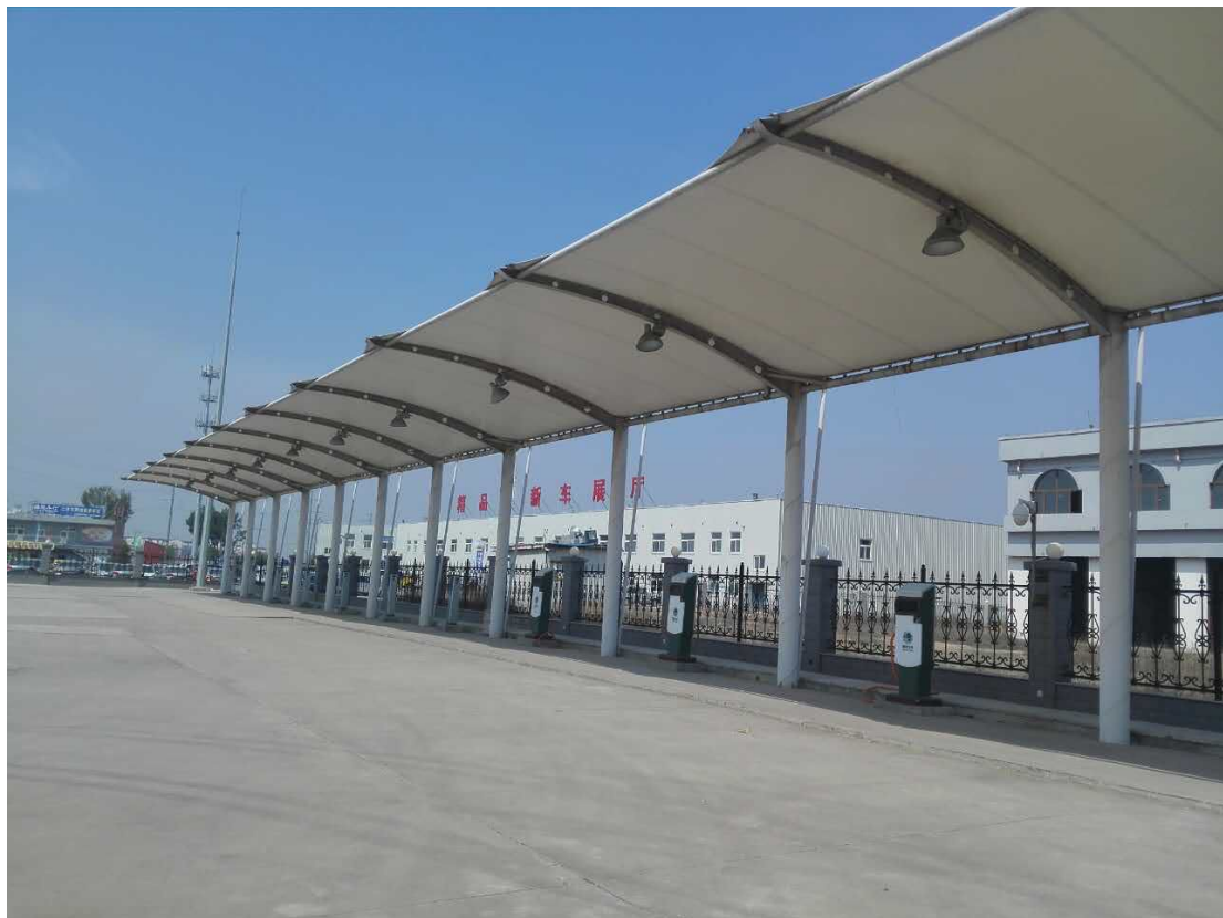
图 1 大同汽车园区电动汽车充电站
